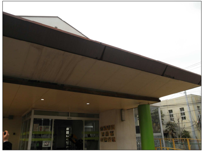
写真26 中村特別支援学校 車寄せの屋根の雨漏りで外装剥離寸前。
