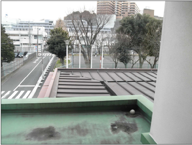
写真25 中村特別支援学校 車寄せの屋根の雨漏りか所
