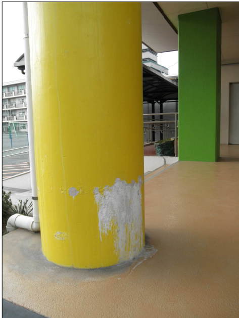
写真27 中村特別支援学校 車寄せ屋根の雨漏りで柱にシミ、カビ、汚損。
