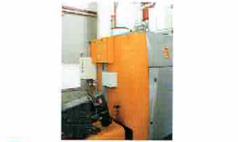
K 市立座光寺保育園 ペレットボイラー
