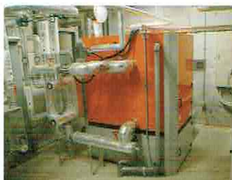
チップボイラー
