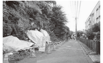
台風18号で崖崩れが起きた永田小学校前の道路(南区)。ここは避難勧告の対象となっていない地域です。
