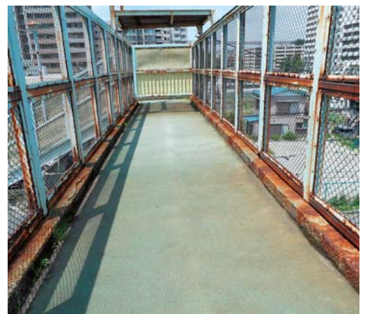
戸塚区上倉田町にある跨線人道橋。鉄部が錆びついて、排水管が下の線路上に落下寸前です。
