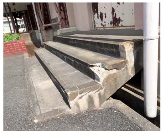
体育館への階段。ひびわれ、コンクリートがずれています。この学校は地域災害拠点に指定されています。神奈川県の市立小学校。
